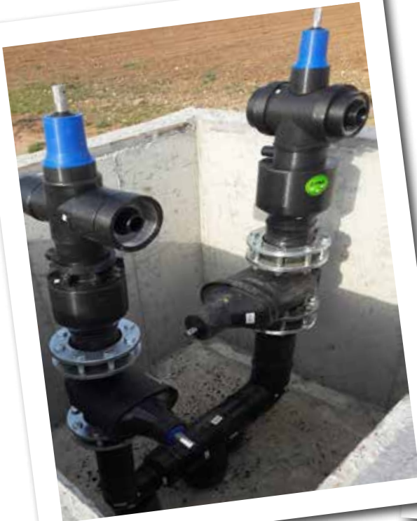
Türkiye / Şanlıurfa - Sulama Hidrantı Turkey / Şanlıurfa - Irrigation Hydrant
