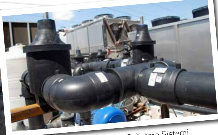
Türkiye - Soğutma Sistemi Turkey - Cooling System
